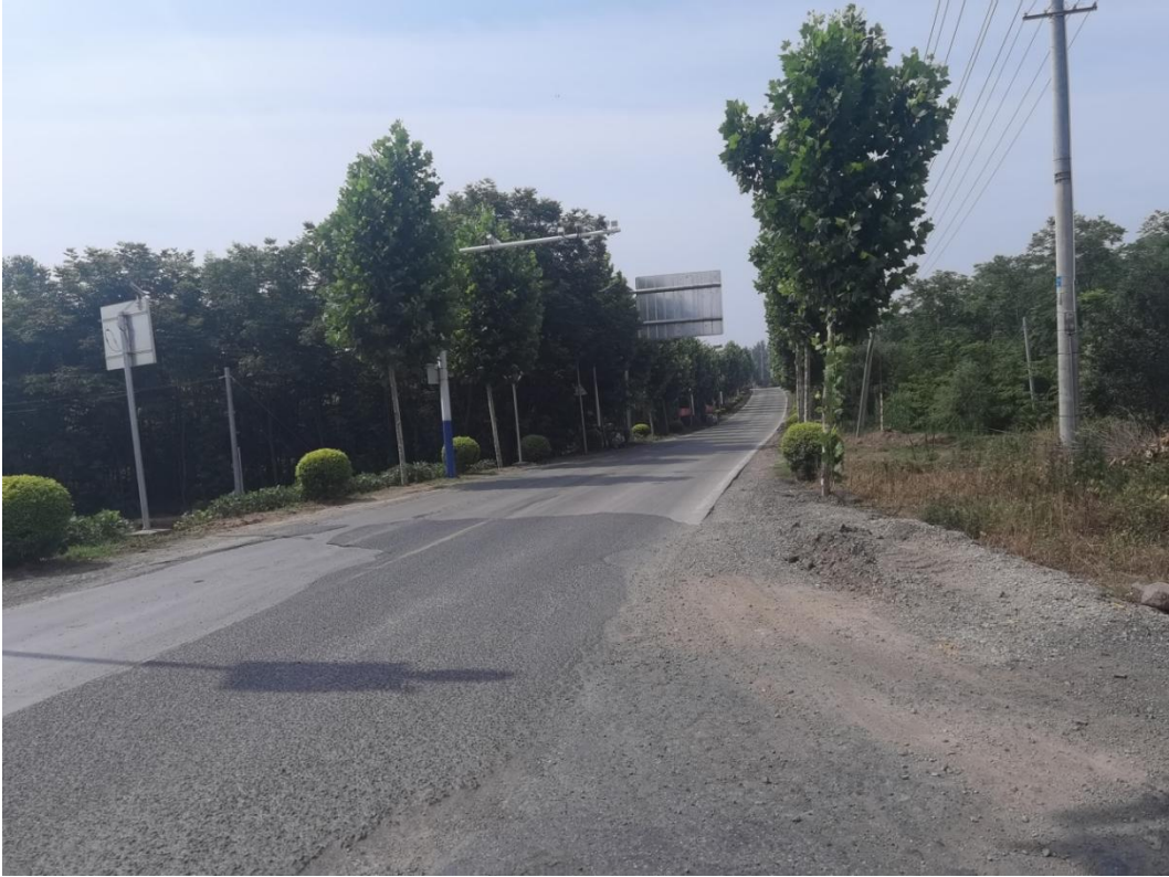
图 7 G235 国道现状（路窄、无路肩）
